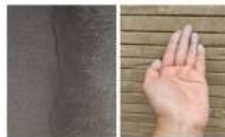
壁のひび割れ 手に白い粉がつく
